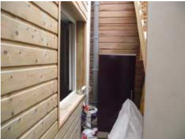
Cour R+1, avec escaliers Les pièces principales s'ouvrant sur cette cour souffrent d'un manque de ventilation, voire d'éclairage, et d'un vis-à-vis prégnant.
