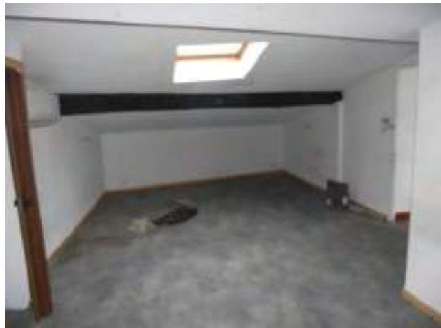
Chambre hauteurs insuffisantes : ~3x0,5m sous hsp >2,20m plancher un peu souple
