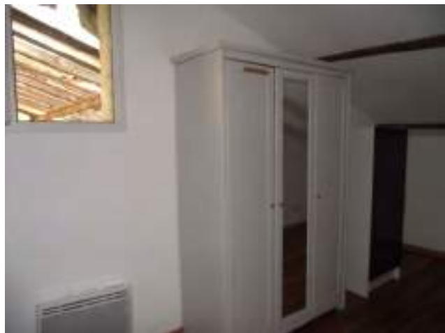
Chambre 2 hauteur sous plafond insuffisante : hsp 2,20m sur moins de 7m2 d'emprise
