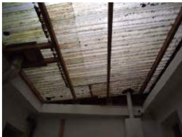
Niveau R+1 : cour couverte par onduline L'onduline nuit à l'éclairage et la ventilation directe des logements (lots 3 et 4)
