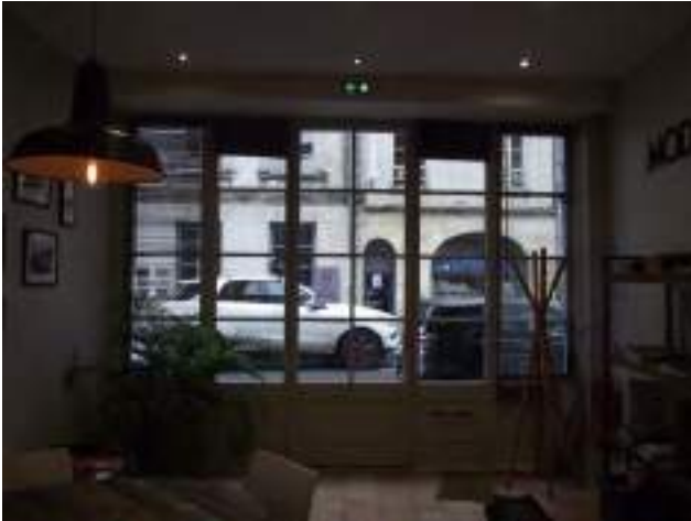
Vitrine neuve, local réhabilité été 2017 Une fuite est apparue sous le caisson d'habillage du linteau de renfort.
