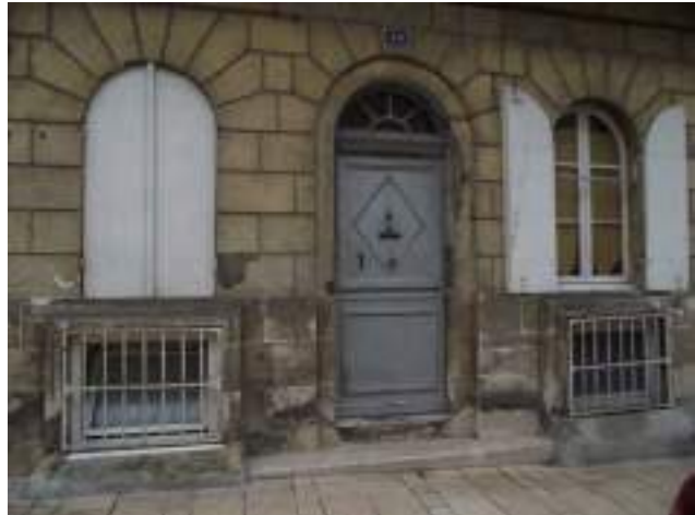
Épaufrures soubassement : garnissage ciment sopiraux : à gauche : cave aménagée logt RDC/A/48 à droite : cave du 46
