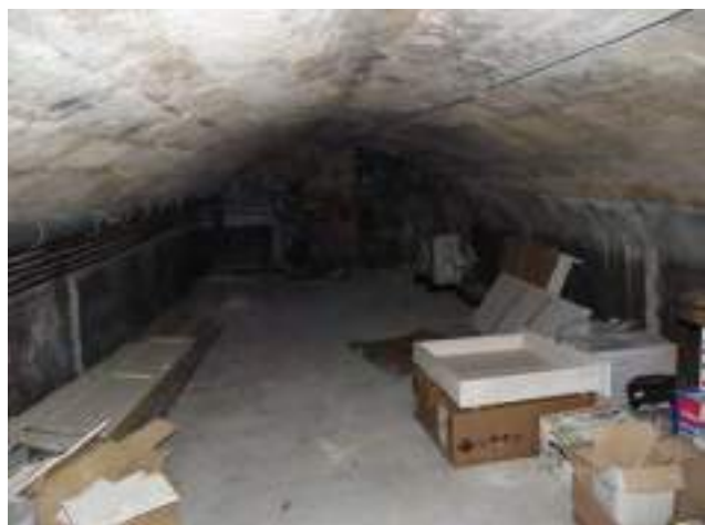
Partie voûtée absence d'humidité On peut cependant noter des matériaux non respirants : sol et soubassements cimentés
