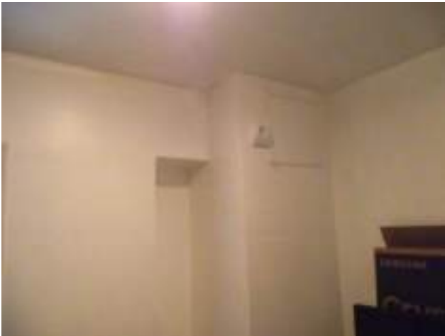
Chambre 2 : détail trappe vmc, extraction vmc (normalement située en pièce humide), trace de remaniement
