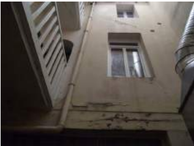
Façade sur cour du corps B Pierre enduite au ciment et peinte, re-fissuration des garnissages
