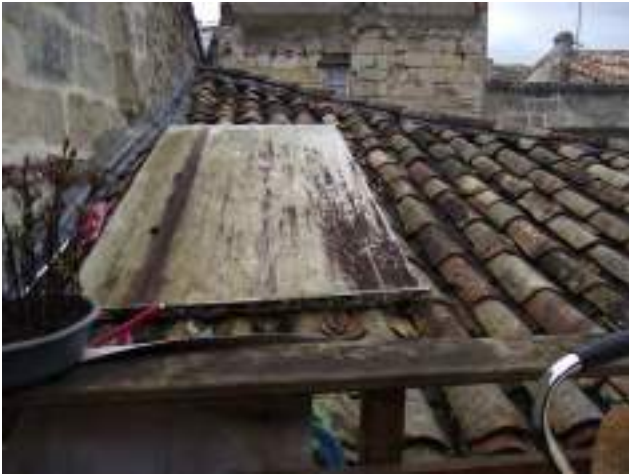
Toiture du corps B vue depuis le balcon en cour 1 arêtier un peu fléchi, tuiles canal , dépôt ?
