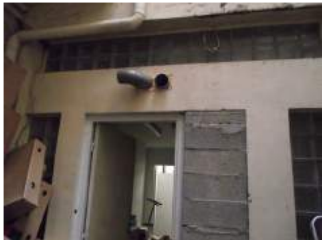
Façade sur cour du corps B Baies remaniées, parpaings de rebouchage non enduits, pavés de verre et PVC, saillies de tubes PVC Cour encombrée
