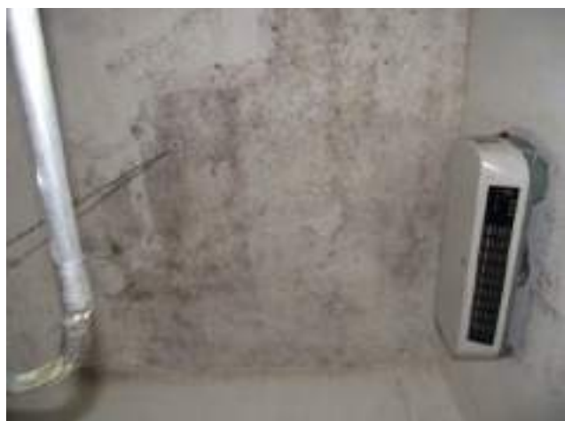
Salle d'eau moisissures en plafond
