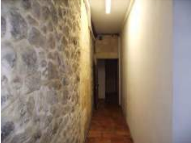
Couloir (chauffé) menant à la cage d'escalier Quelques carreaux fendus
