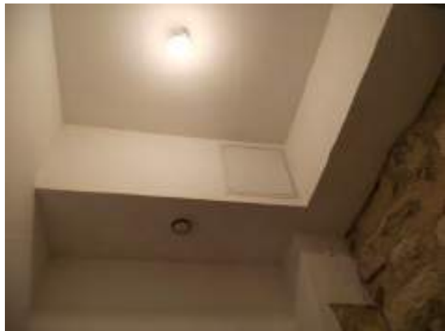
Trappe accès VMC
