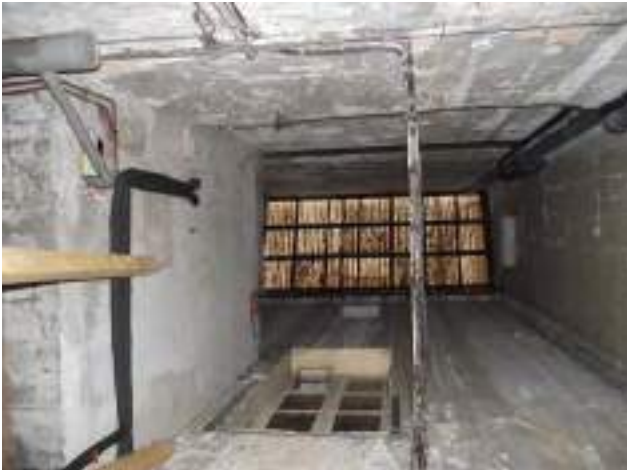
Couverture polycarbonate, façades pierre peintes et écaillées en face : fenêtres du logt R+1/B-Cduplex, éclairage insuffisant à gauche : salle d'eau du logt R+1/A/48 en excroissance (cloison briquelette couverte de polycarbonate)
