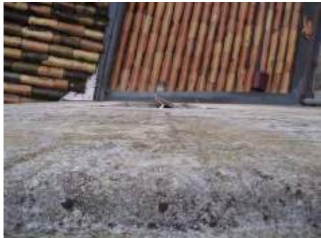
Héberge corps B sur arrière du 44 Fonneuve pierre noirci sous appui, volets bois dégradés
