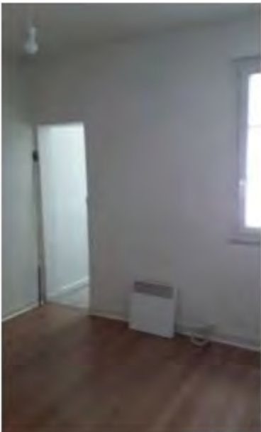
Chambre : la fenêtre de la chambre donne sur les communs (absence d'ouverture sur l'extérieur) : non conforme RSD Au fond, accès SDE (absence de porte)
