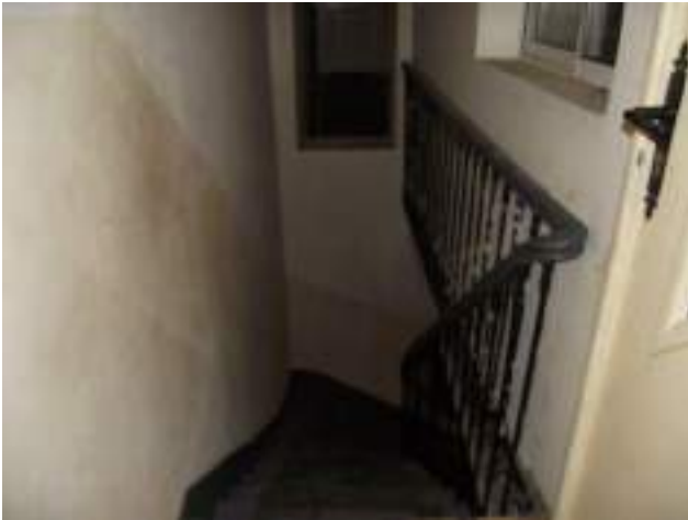
Escalier ancien du corps A, vu du palier R+1 le palier a été bâti. En face : baie donnant sur escalier B. A droite : fenêtre du logt R+1/A : protection au feu à avérer
