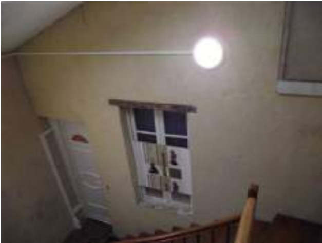
Accès logt VH R+1, porte PVC, paroi fissurée Accès combles perdus corps A à droite
