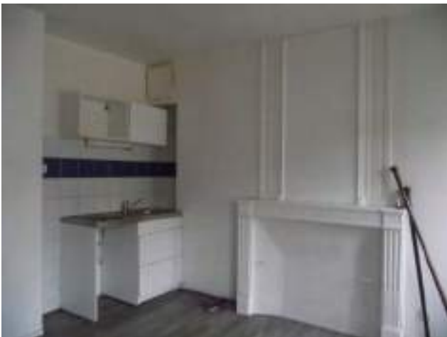
Séjour : coin cuisine absence de la bouche sur l'extraction vmc
