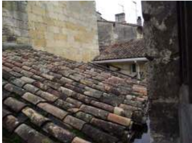
Toiture du corps B, chéneau plein mauvais état, possible source des infiltrations touchant le logt R+1/B/arr duplex. Au fond : cour arrière ouverte(structure sans verrière) et corps C
