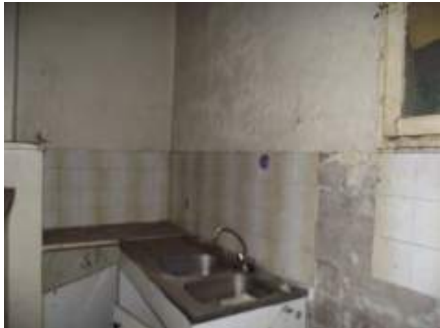
Séjour : coin cuisine Dégradé suite infiltrations
