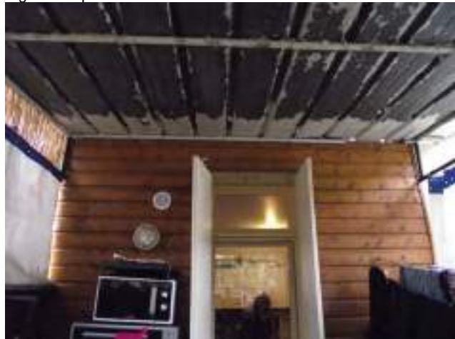
Terrasse couverte la couverture en acier nuit au parfait éclairage du séjour.
