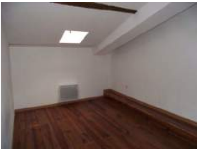
Chambre 1 hauteur sous plafond insuffisante : hsp 2,20m sur moins de 2m de largeur
