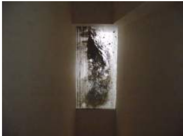
Châssis en polycarbonate en désaccord avec patrimoine ancien, salissures
