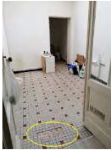
Séjour pièce non ventilée sur l'extérieur sol affaissé (surplombe la cave ?)
