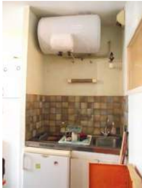
Kitchenette en niche séjour : équipements vétustes et bruyants
