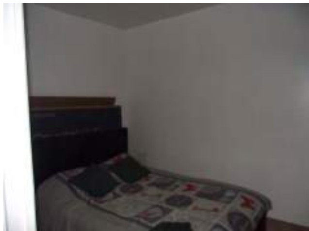
Chambre 2 pièce non éclairée ni ventilée directement sur l'extérieur
