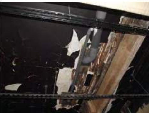
Plafond plâtres anciens fissurés, lattes endommagés absence de protection au feu du logt R+1/A
