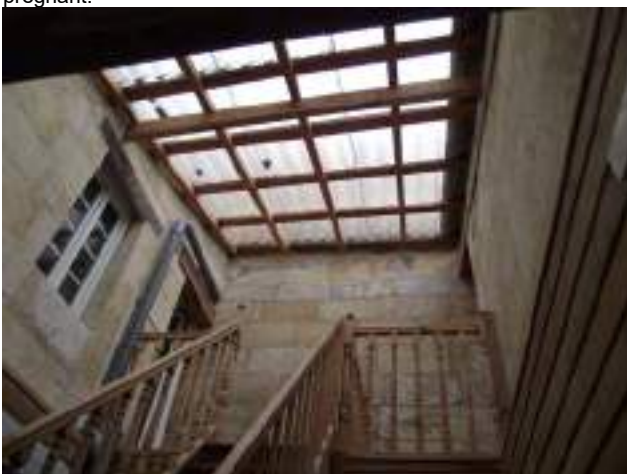
Vue vers palier R+2 couverture en polycarbonate, nuisant à la ventilation naturelle des pièces s'ouvrant sur cour.
