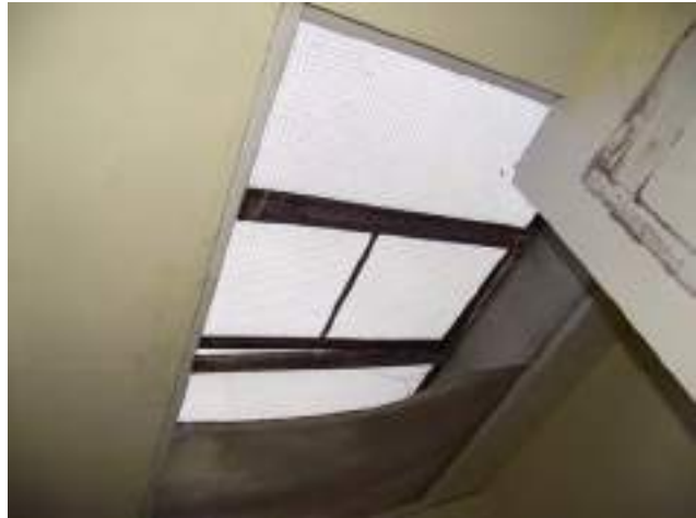
Volée haute : puits de jour verre armé, dont un fendu plaque de polycarbonate altérée
