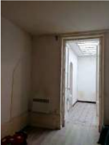
Pièce pièce non éclairée ni ventilée sur l'extérieur
