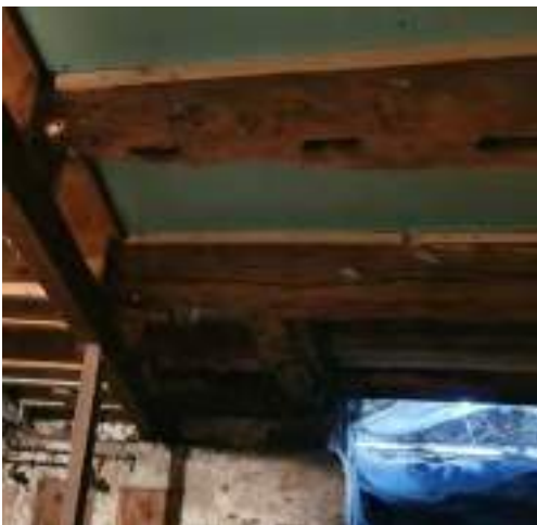
Cave solivage fléchi, lames remplacées par des panneaux hydrofuges calés étais métalliques, corrosion sur certains éléments métalliques à surveiller
