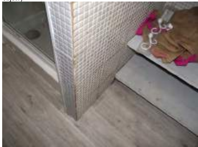
Salle d'eau : détail infiltrations (résorbées?) ayant affecté le plafond du couloir des communs. État du plancher ?
