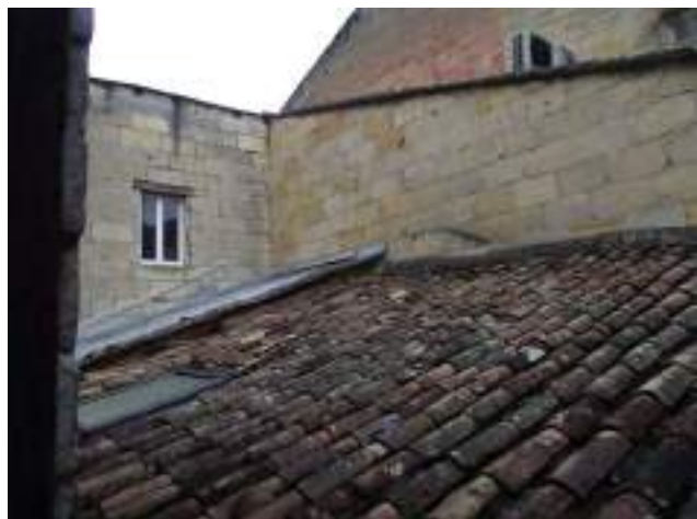
Mur arrière du corps A, surplombant le polycarbonate fissures
