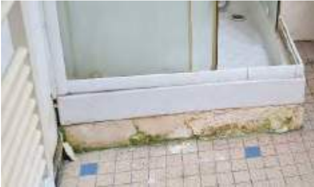
Salle d'eau mousses en pied de bac de douche
