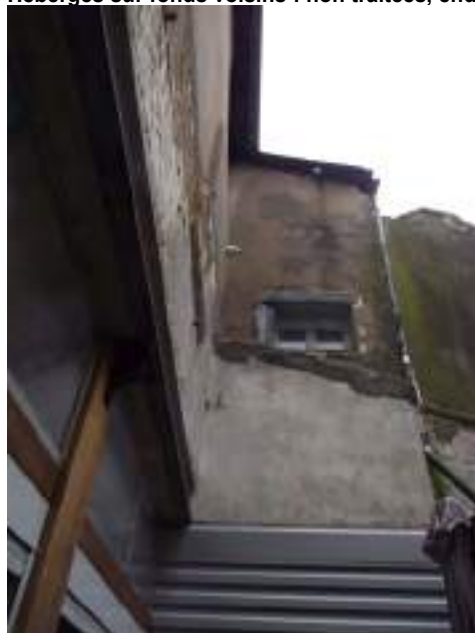
Héberge du corps JS (excroissance) sur cour voisine (photo 2018) : enduits altérés, traces d'une ancienne toiture, rebouchages ciment, zinguerie EP connectée au réseau voisin
