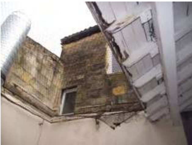
Façade arrière corps A Pierre pulvérulente, baies remaniées sans retaille de tableau boisseau de la cuisine du commerce : courte, odeurs au R+3/A A droite : toiture cursive, peinture écaillée
