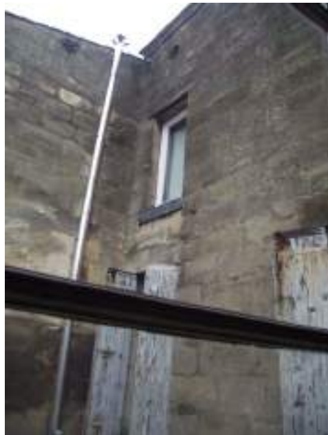
Cour : façade cour du corps VH : fenêtres PVC, volets bois altérés, joints ciment, pigeons logeant dans les combles (œil de bœuf)
