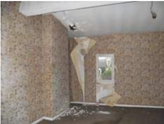
Chambre 1 s'éclairant sur le puits de jour et en héberge sur arrière du 44 rue Fonneuve Dégât des eaux
