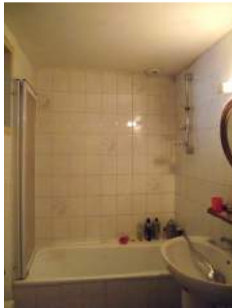
Salle de bains chant plat le long de la baignoire masquant le déjointoiment probablement dû à l'affaissement de plancher après infiltrations.
