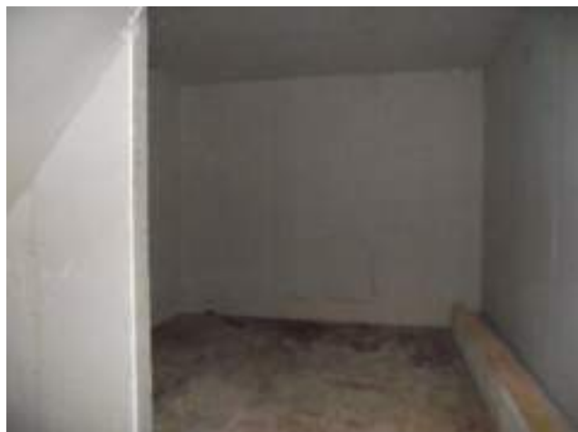
Fond du local ancienne porte condamnée (donnant sur pièce noire du logt RDC/B)
