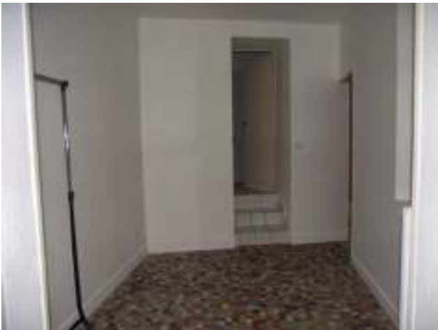
Pièce au fond : accès sde et wc à droite : accès cave (chambre) et fenêtre sur cage d'escalier (isolation au feu?)
