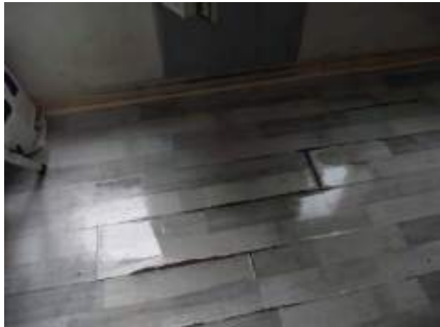
Détail séjour : parquet altéré, plancher fléchi
