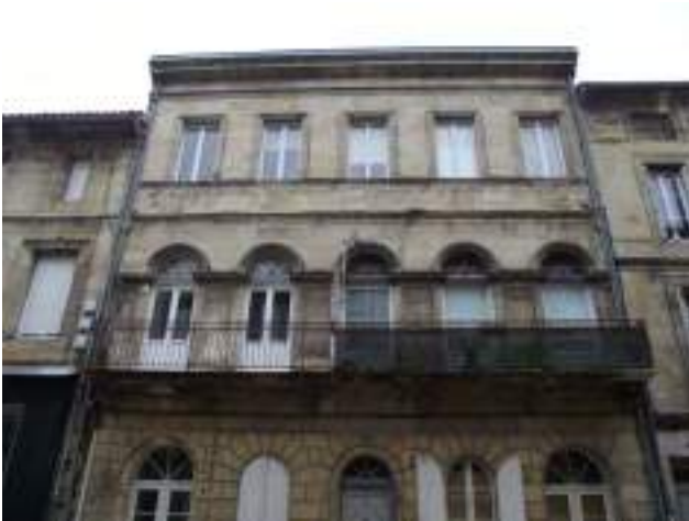
Façade sur rue immeuble cosu quelques épaufrures, déjoints, menuiseries dépareillées
