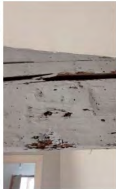
Salle d'eau poutre fendue et présentent des traces de xylophages (peut-être anciennes).
