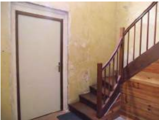
Porte arrière du local du 42 rue Victor Hugo, salpêtre
