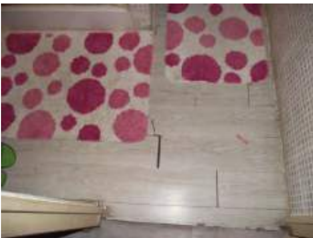
Salle d'eau : détail parquet parquet flottant déjointé, affaissement du plancher
