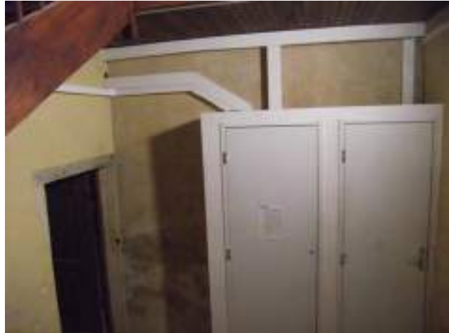
Cage d'escalier : placards électriques récents en RDC salpêtre contre mitoyen
