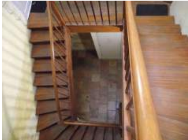
Escalier bois, palier R+1 : petit affaissement
