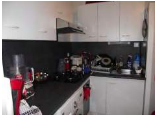
Coin cuisine bouteille et plaque gaz : absence de ventilation dédiée
