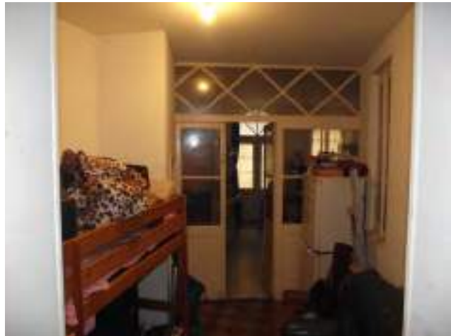
Pièce distributive fenêtre donnant sur la cage d'escalier. Absence de ventilation et d'éclairage direct.
