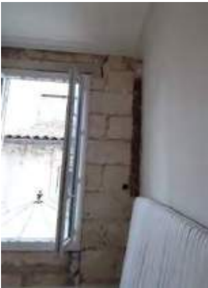
Chambre, côté cour moisissures, paroi fissurée
