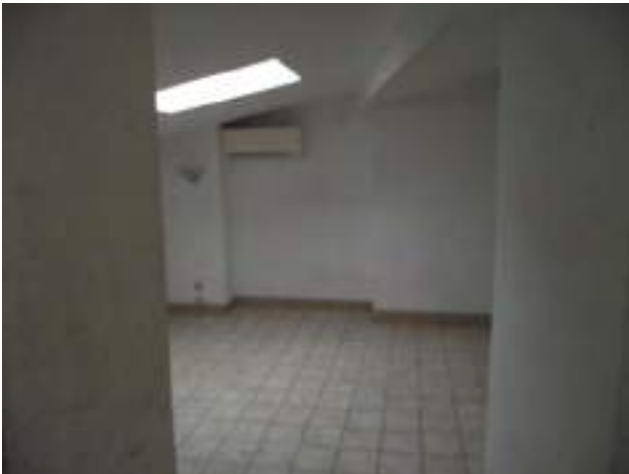
Séjour hauteurs insuffisantes : ~2,8x2,5m sous hsp >2,20m
