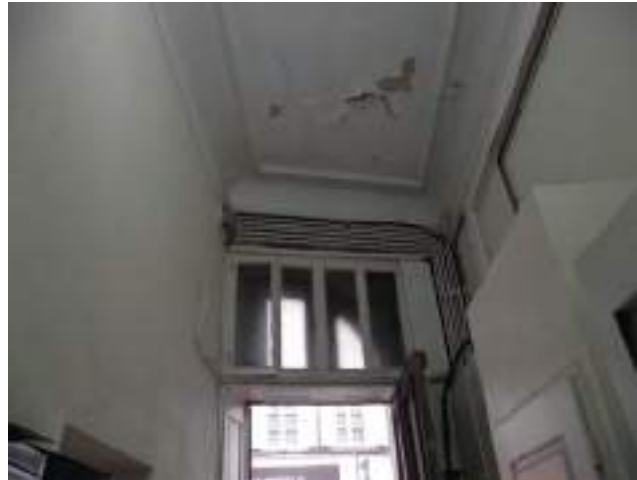
Réseaux apparents en imposte et non guidés, plafond écaillé Placards techniques compartimentés
