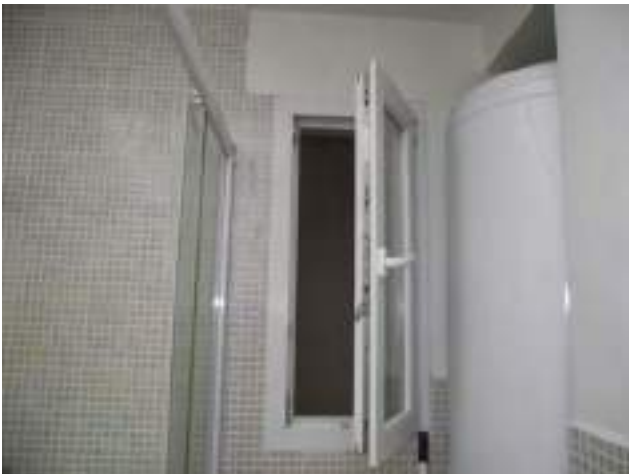
Salle d'eau fenêtre sur cage d'escalier : protection au feu à avérer
