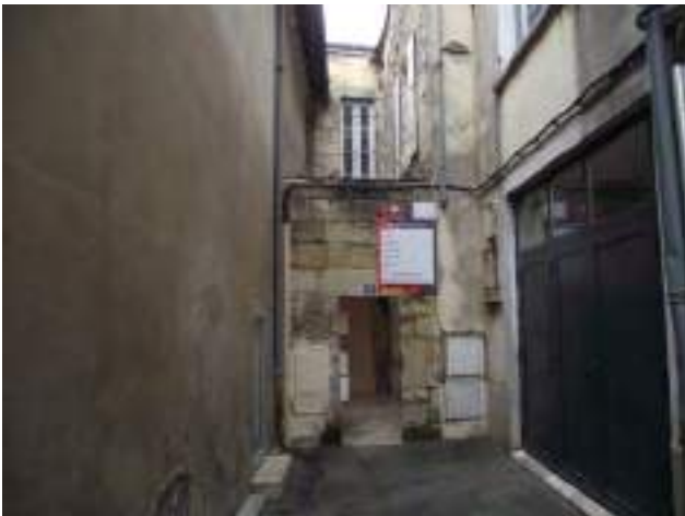
Accès 20 impasse Jules Simon pierre altérée, porte endommagée, descente EP obsolète arrivées gaz (obsolète) et élec
