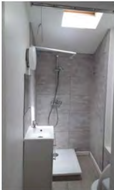
Salle d'eau Absence de VMC absence pare-douche : risque électrique, risque dégradation sol
