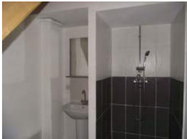
Salle d'eau (le wc est installé sous la volée de marches) absence de vmc
