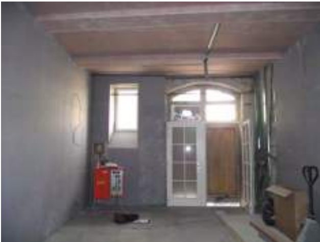
Vue vers l'entrée en projet : transformation des volets externes et création caisson d'habillage pour la double-porte d'entrée
