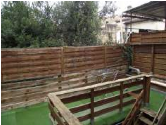
Terrasse du logt RDC/B, à niveau R+1 pare-vues léger en bois, en héberge sur la cour du 49 rue Clément Thomas. Gazon synthétique sur paxalu.
