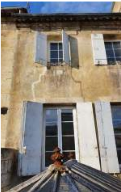
Façade arrière du corps A, en surplomb de la verrière sur cour fissures, rebouchages ciment
