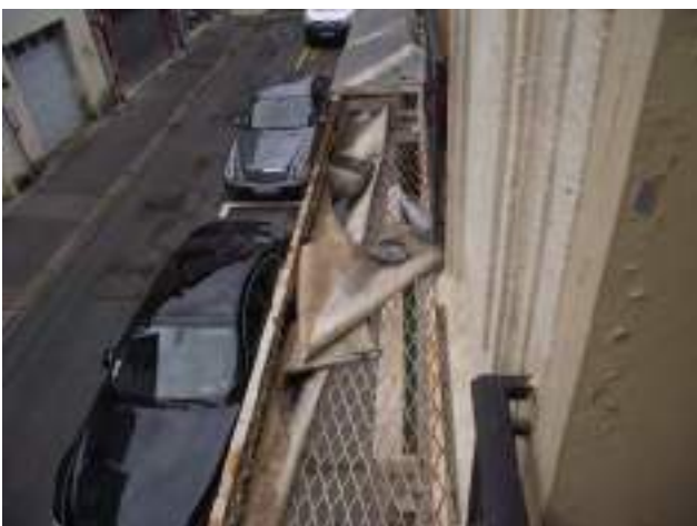
châssis métallique sous balcon : non qualitatif (protection de chute d'objet?)
