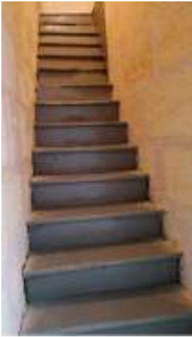
Escalier raide, nez de marche cassés
