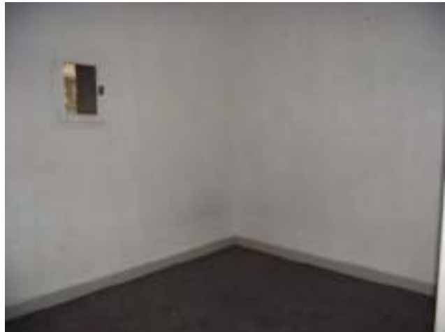
Alcove trop sombre, petite fenêtre en héberge au dessus des toitures voisines
