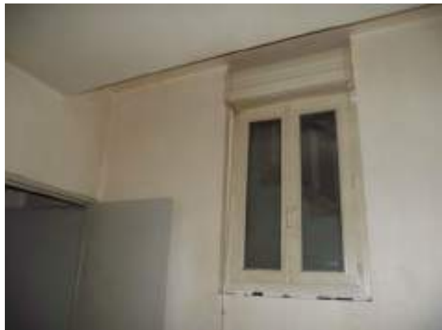
Chambre pièce trop sombre, fenêtre PVC sur cage d'escalier
