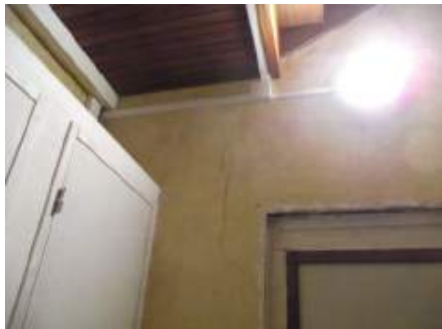
Fissure mur arrière local (se reproduit à l'étage)
