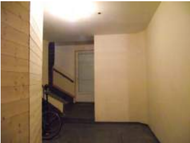
Cage d'escalier (emprise cour 1 jusqu'au refend : reste du mur de façade du corps B)
