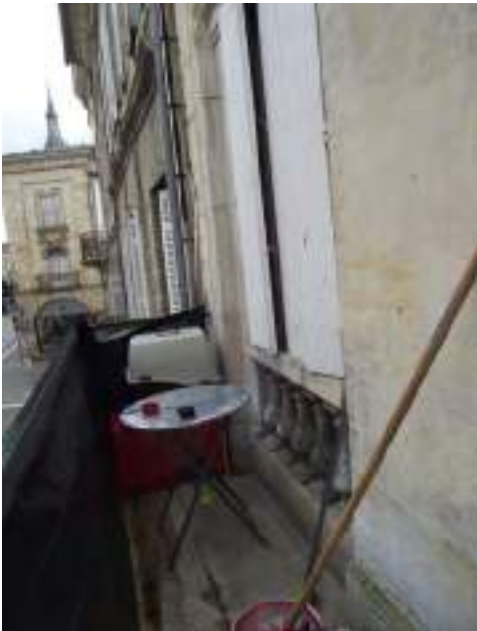
Balcon filant . Stagnation d'eau. Un appui cassé.
