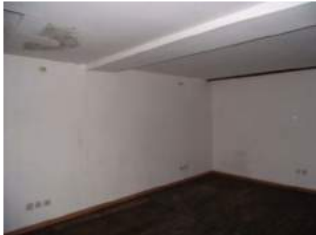
Séjour sombre, traces d'infiltrations au plafond (voir photo de la toiture et du chéneau)
