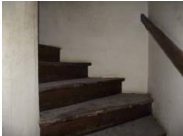
Escalier dégradé suite infiltrations, une marche cassée
