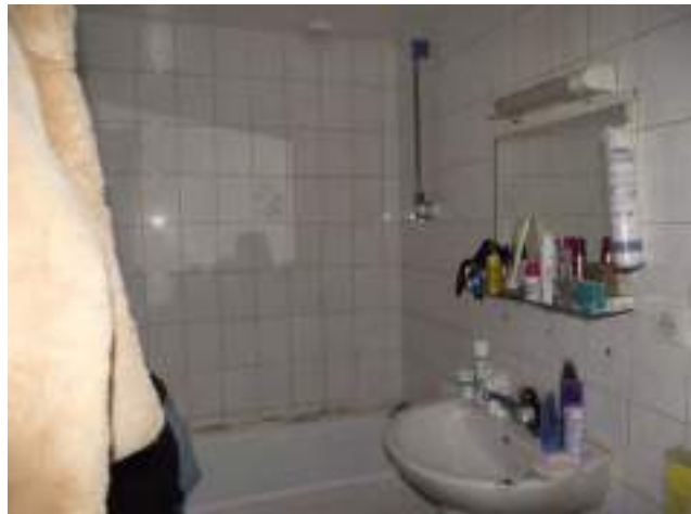
Salle de bains déjointoiement probablement dû à l'affaissement de plancher après infiltrations.
