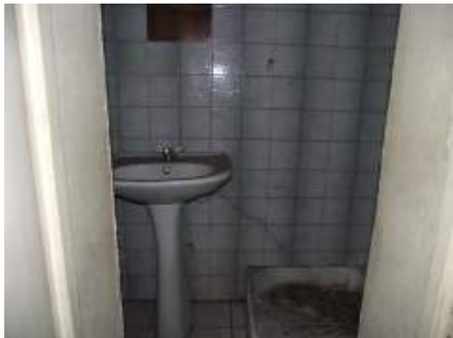
Salle d'eau bâtie en enclave sur fond voisin. Dégradée par infiltrations
