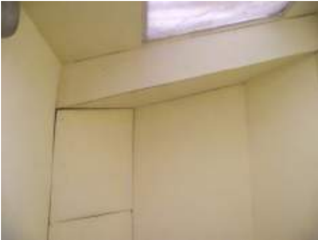
Volée haute : puits de jour coffrage de gaine non jointif (type de réseau non connu) protection au feu à avérer
