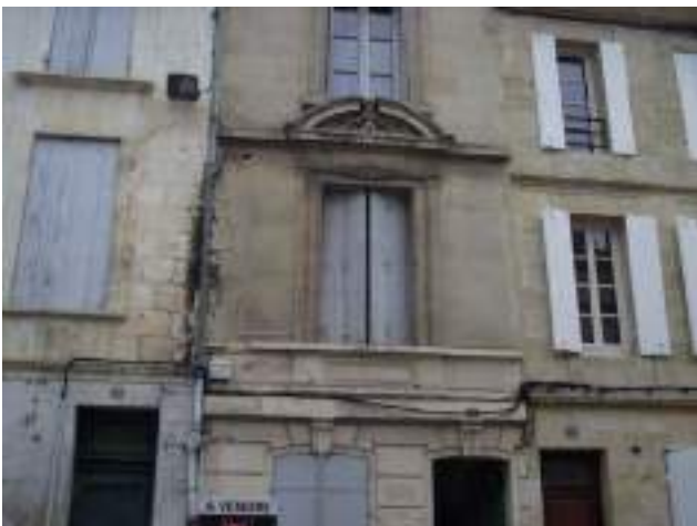
Façade sur rue : peinture écaillée et mousses au RDC. Détérioration zinguerie EP et pierre au R+1. Eaux usées se jetant dans la descente d'eaux pluviales. Menuiseries bois altérées. Porte d'entrée dégradée.
