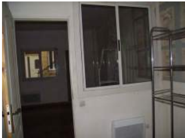
Chambre, vue vers séjour chambre non ventilée ni éclairée sur l'extérieur
