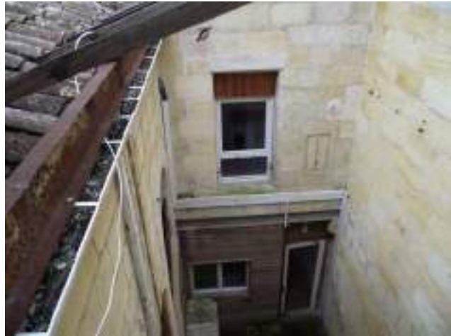
Façade arrière du corps B baies remaniées, PVC, bardage bois au rdc. IPN rouillé, servant de sablière à l'ossature, projet de couverture en polycarbonate ? Gouttière : gravats
