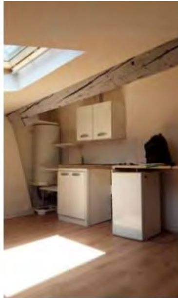
Séjour sous pente : kitchenette poutre fendue et présentent des traces de xylophages (peut-être anciennes). Absence de VMC
