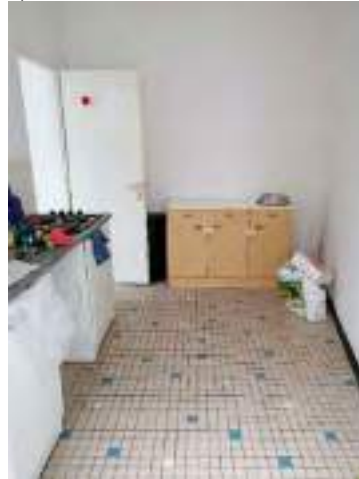
Cuisine moisissure dans l'angle au fond à gauche absence de vmc et d'ouvrant
