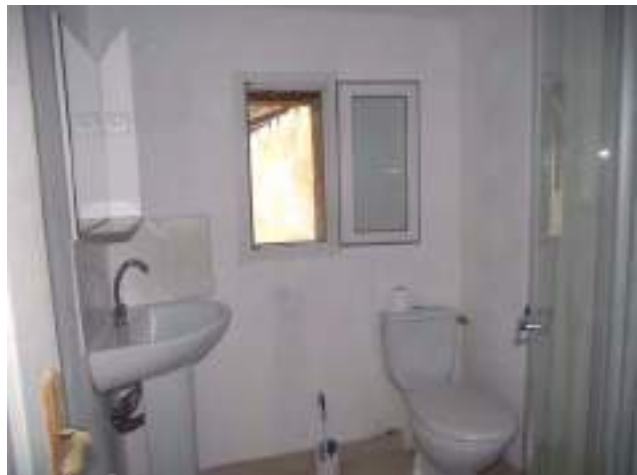
Salle d'eau absence de vmc, fenêtre pvc
