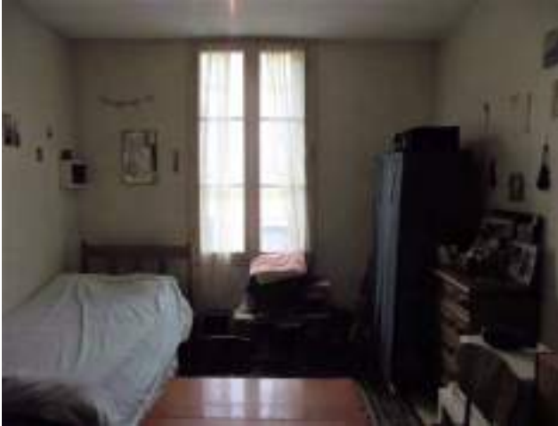
Séjour fenêtre défectueuse sol usé
