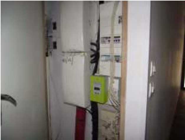
Placard électrique installation récente
