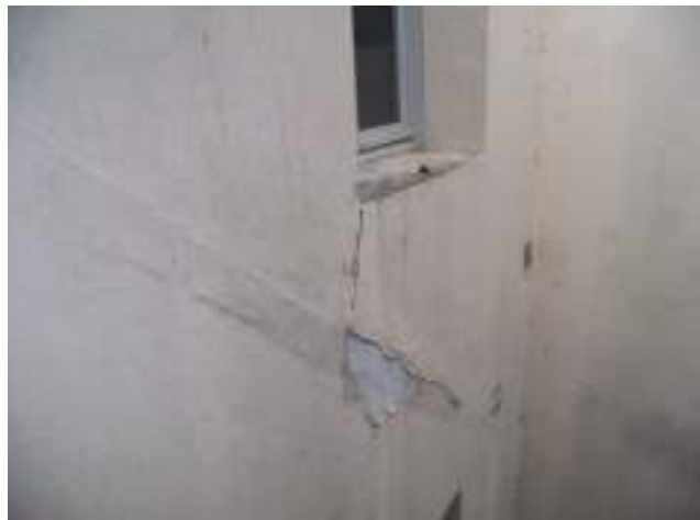
Fissures façade sur cour du corps B D'anciens traitements de fissure se rouvrent.. Des fissures sont aussi visibles sur les coursives.
