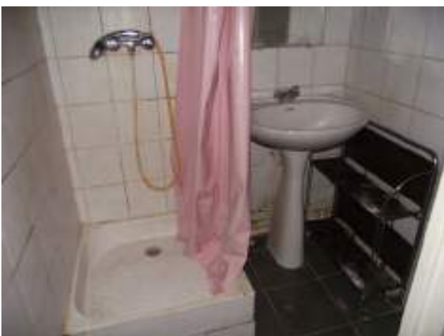
Salle d'eau absence de vmc
