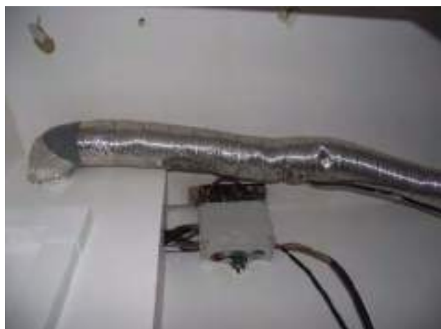
Placard : exutoire vmc vers façade, cumulus
