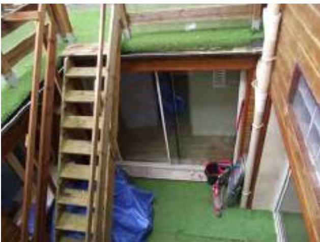
Cour 2 et accès à la terrasse du logt RDC/B escalier très raide, garde-corps non conforme
