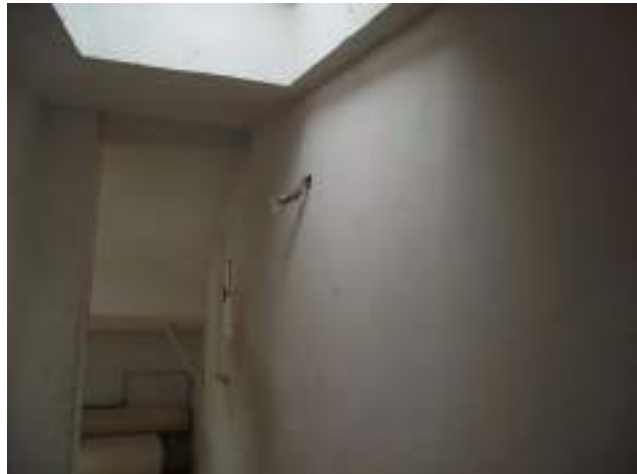
Dégagement vers séjour éclairé par un vélux . Fileries non protégées.
