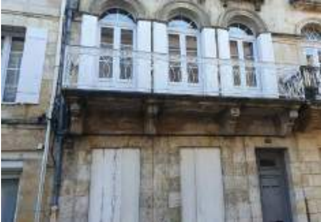
Façade sur rue salissures au niveau des reliefs, fenêtres PVC jolies ferronneries peintes
