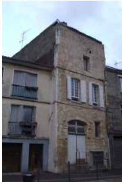
Façade Jules Simon : façade ravalée récemment, tirants maintenus la partie haute de la façade est un acrotère masquant la pente du toit.
