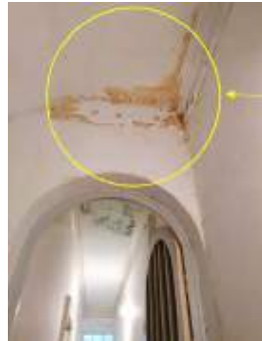
Accès logt RDC/B traces d'infiltrations (résorbées?)
