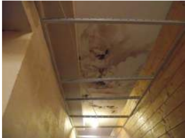
Plafond couloir traces d'infiltrations (sous sde logt R+1/A), résorbées ? protection au feu à avérer.
