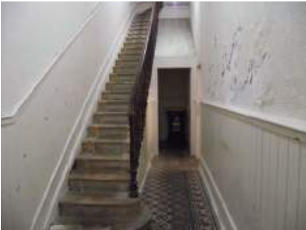
Jolis carreaux de ciment, parois altérées, escalier pierre et garde-corps bien conservés Absence de locaux communs
