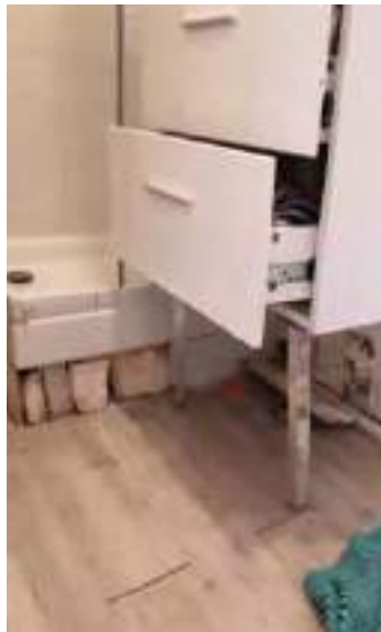
Salle d'eau affaissement du plancher, bac défaillant
