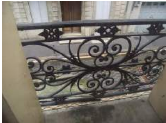
Garde-corps chambres hauteur insuffisante. Présence d'un châssis grillagé sous les baies (protection chute objet?)
