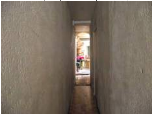
Couloir vers cage d'escalier et cour parois pierre enduites (non respirant)
