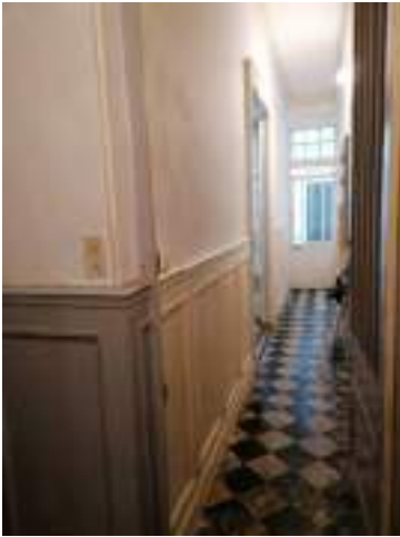
Couloir d'entrée sol altéré, humidité
