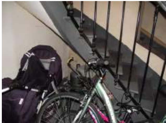
Volée d'escalier d'origine (la seule subsistant) absence de local vélo-poussettes
