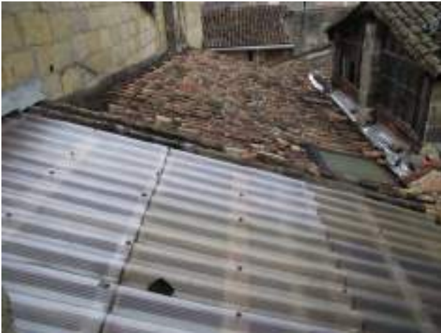
Toiture en polycarbonate de la cour couverte cette couverture nuit à la ventilation des pièces principales des logements. À droite : petit édicule du 20 place A.Surchamp surplombant les toitures du 21.
