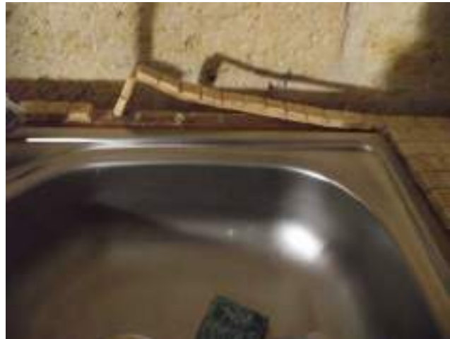
Revêtement du plan dégradé
