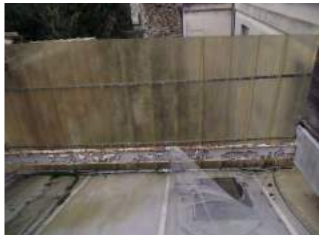
Pare-vue (?) polycarbonate en héberge sur la cour du 58 rue Waleck Rousseau ; couverture en polycarbonate de la cuisine du logt R+1/A et de la salle d'eau du logt R+1/B
