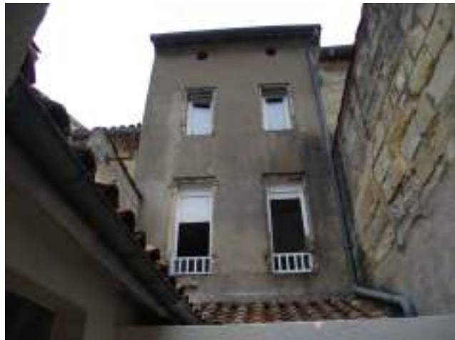
Façade arrière du corps A : pierre enduite au ciment, en mauvais état menuiseries alu et PVC.
