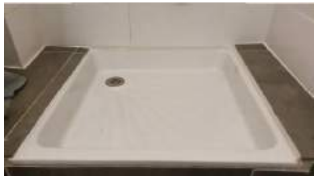
Salle d'eau suite rapport hygiène : extracteur mis en place plancher affaissé repris sous receveur, joints refaits (péril levé)
