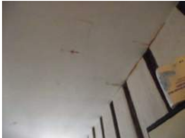
Séjour : traces d'infiltration en plafond
