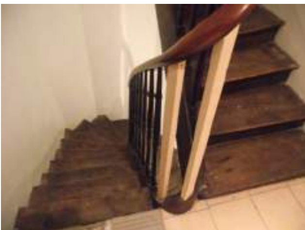
Escalier bois et palier R+1 bois non protégé, main-courante réparée, un carreau cassé
