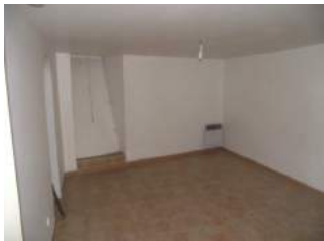
Cave aménagée en chambres : non conforme au RSD à gauche petite alcove ancien puits.
