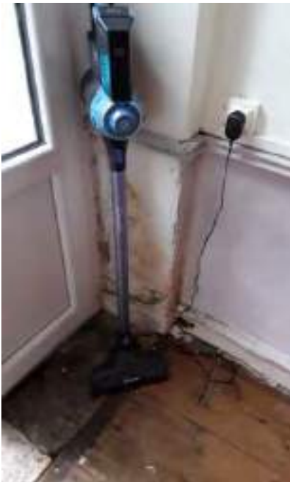
Séjour, côté balcon infiltrations depuis le balcon, humidité
