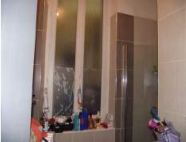
Salle d'eau, fenêtre donnant sous onduline emprise grévant la chambre 2.
