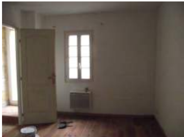
Chambre 1 fenêtre PVC donnant sur cour couverte chambre ne s'éclairant ni se ventilant directement sur l'extérieur
