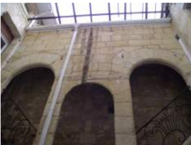
Cage d'escalier ouverte mur pierre peu épais, pierre un peu altérée zinguerie alu, trace d'une infiltration depuis gouttière
