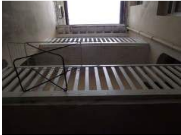
Coursives structure bois ? Couvertes de sol souple PVC, peinture fissurée en sous-face
