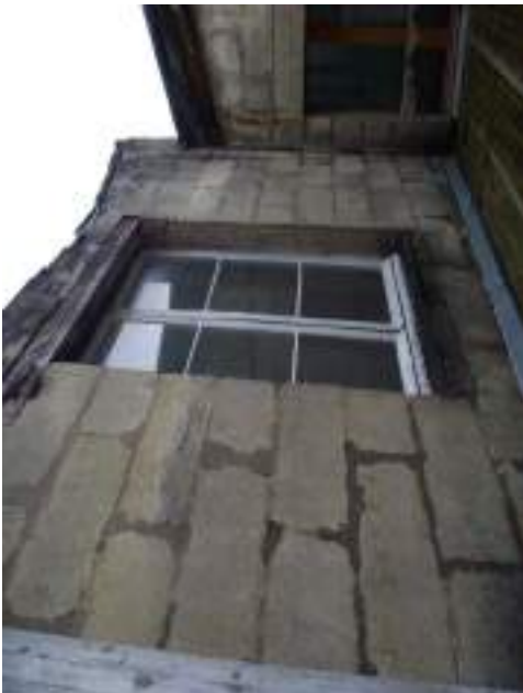
Cour : façade de la cage d'escalier : bois non protégé, fenêtre vétuste, joints ciment
