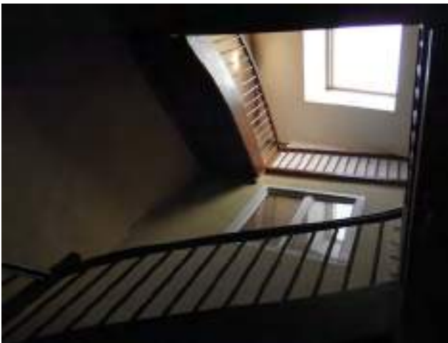
Châssis de toit éclairant la cage d'escalier, fenêtre PVC du logt JS R+1
