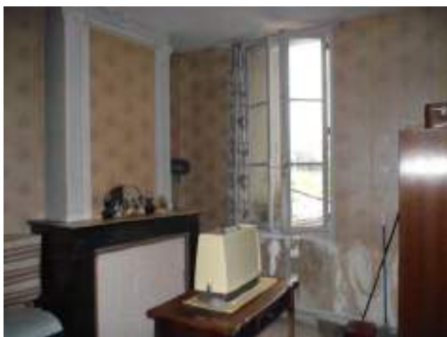
Chambre fenêtre donnant sur arrière du 44 rue Fonneuve bois simple-vitrage
