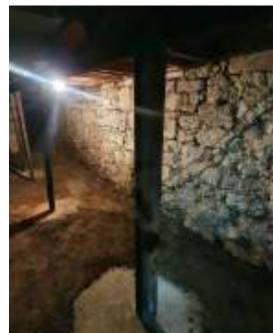
Cave étais ajoutée (péril levé) déjoints pierres/moellons sur le côté
