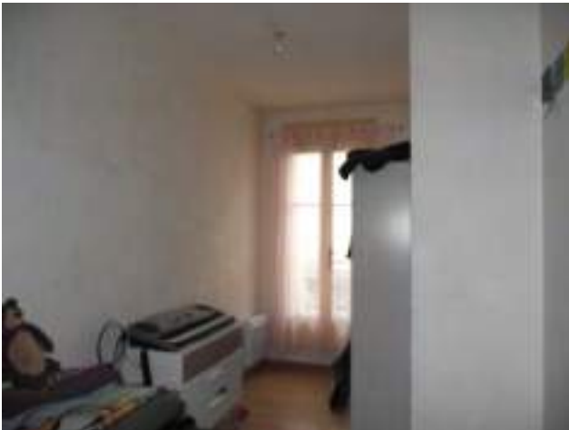
Chambre 2 configuration en L ne présentant pas une surface conforme au Règlement Départemental Sanitaire.
