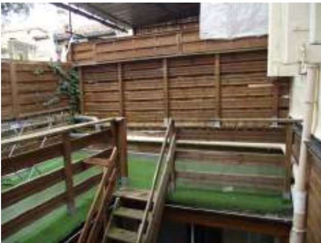
Terrasse R+1 gazon synthétique sur paxalu, garde-corps non conformes En face : séparatif en bois léger de la terrasse couverte du logt R+1/B
