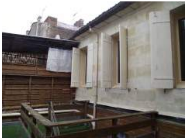
Façade ravalée du 1 er étage du corps B vue depuis la terrasse du logt RDC/B présence de tapées en OSB
