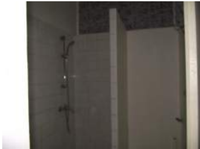
Salle d'eau bâtie en puits de jour avec paroi séparative légère (isolation au feu?)
