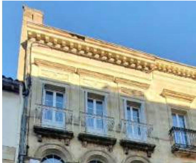
Façade sur rue corniche ébréchée
