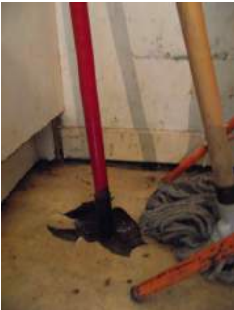
Plancher affaissé, dé jointoiment pied de cloison salle de bains sol abîmé
