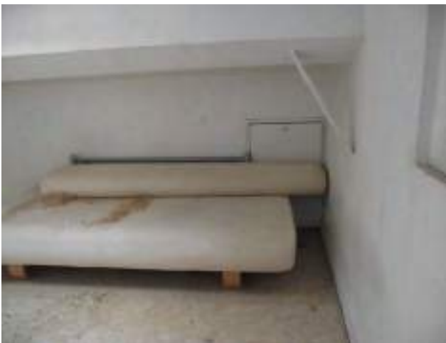
Séjour Hauteur maximale 2,05m : insuffisant, non conforme
