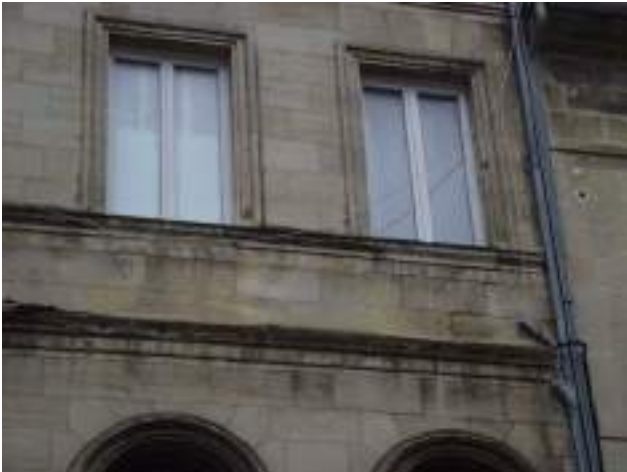
Petite fissure en escalier rejet d'eaux usées aux eaux pluviales filerie téléphonique
