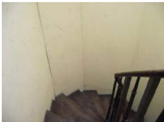
Gaine d'angle dans la cage d'escalier coffrage non jointé
