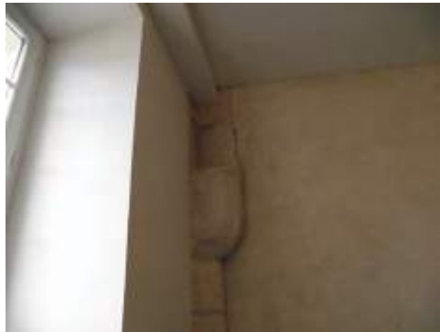
Séjour : fissure verticale entre le tirant haut R+1et le tirant haut RDC
