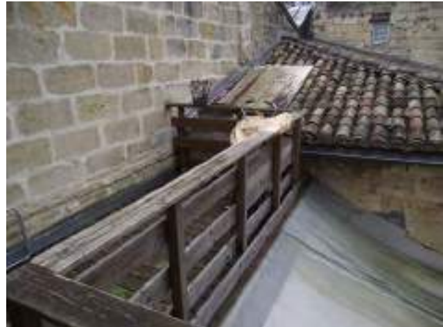
Cour n°1 : balcon surplombant la couverture en polycarbonate de la cuisine du logt R+1/A et de la salle d'eau du logt R+1/B
