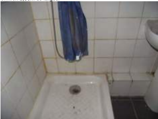
Salle d'eau joints altérés
