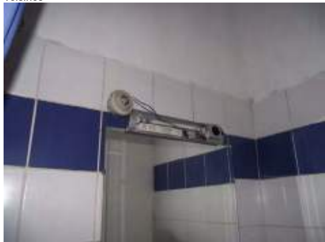
Salle d'eau fileries non protégées
