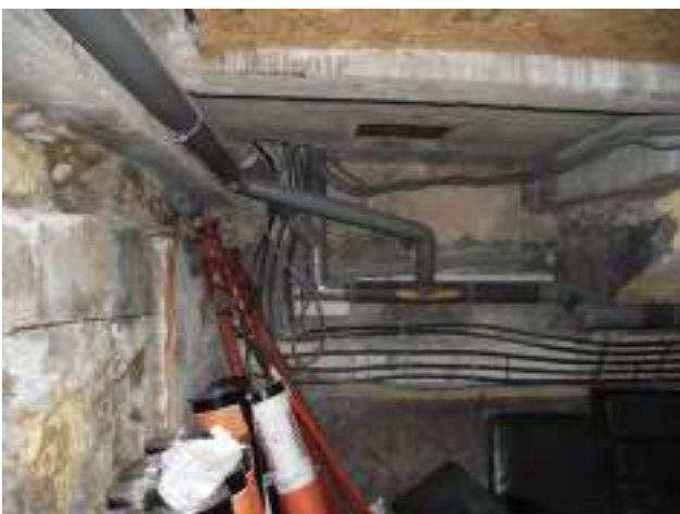
Cave Partie sous plancher OSB : protection au feu non effective Et sous plancher béton. Réseau EU et adduction
