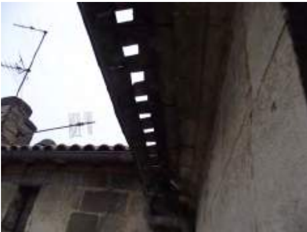
Héberge corps B sur arrière du 44 Fonneuve (à droite) peu de visibilité depuis les fenêtres zinguerie percée
