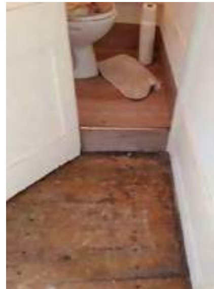
WC humidité du plancher
