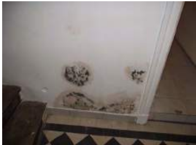
Cage d'escalier : détail moisissure en pied de paroi
