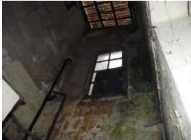
Mitoyen vu depuis la courette du logt R+1/B-Cduplex mur pierre avec fenêtre en héberge su r 52 rue Fonneuve
