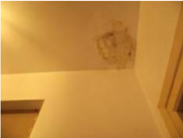
Plafond : traces infiltrations résorbé ?
