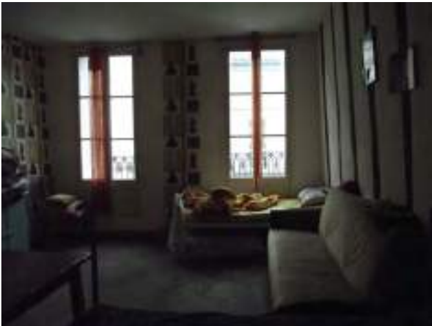
Séjour mitoyen en ossature bois : défaut d'aplomb plancher : flèche vers cheminée porte-fenêtre : ouverture difficile
