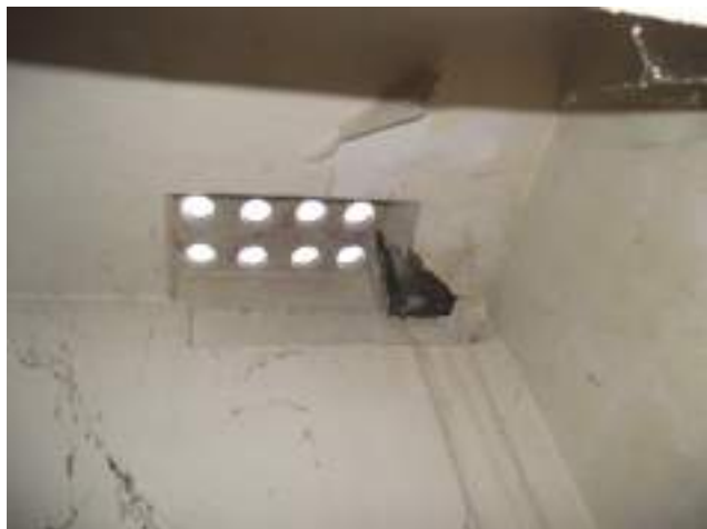
Salle d'eau couverture béton et pavés de verre : infiltrations
