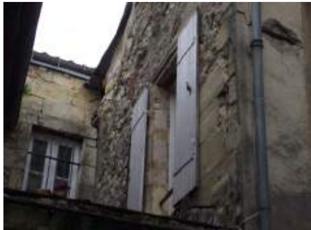
A droite : façade arrière du corps B et androne Arrête fissurée, façade dégradée, rive de toiture non traitée
