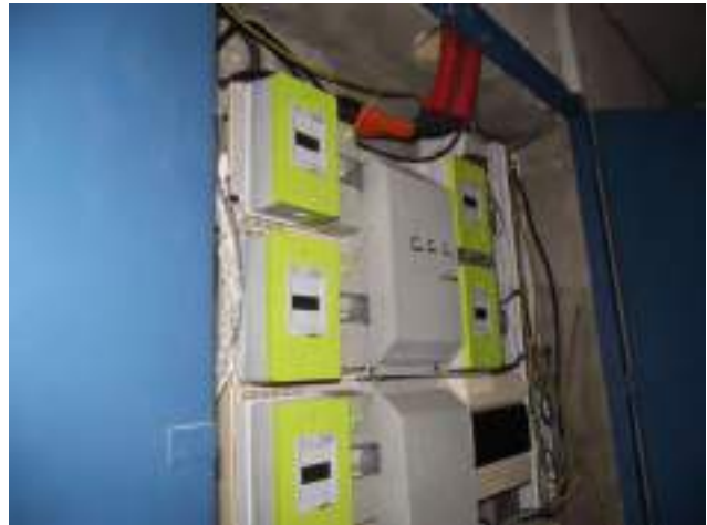
Placard électrique Goulottes non refermées
