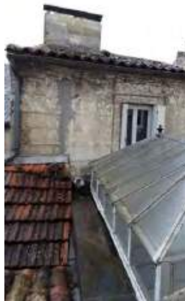
Partie du corps B, axée à la parcelle : au fond : façade fissures, rebouchages ciment devant : verrière et toitures de petits bâtis sur ancienne cour l'ensemble abrite le logement RDC/B
