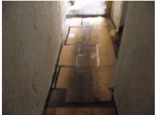
Couloir : cartons revêtant le sol abîmé
