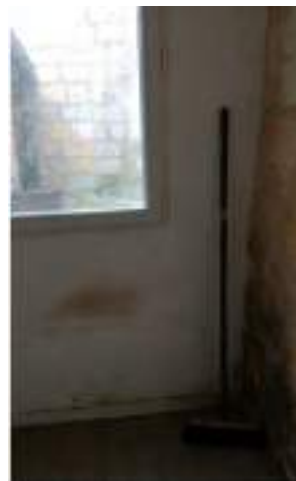
petit couloir réunissant les bâtis humidité pied de mur en pierre
