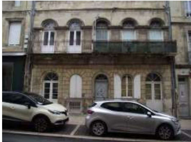
Balcon à droite, récent remplacement de pierre suite à péril garde-corps d'origine rouillé, rive noircie
