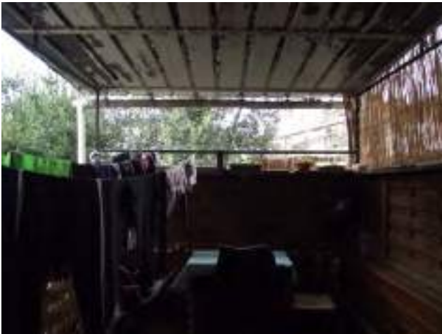
Terrasse couverte bac acier altéré, pare-vues en panneautage bois
