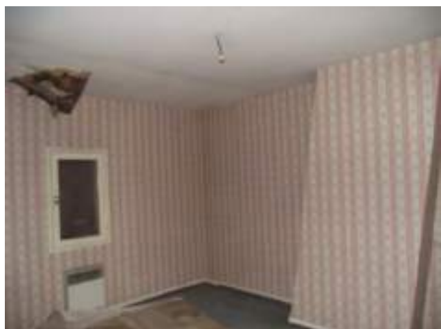
Chambre 3 s'éclairant sur le puits de jour (très insuffisant) Dégât des eaux Existence d'une fissure dans le mur pierre sous l'allège
