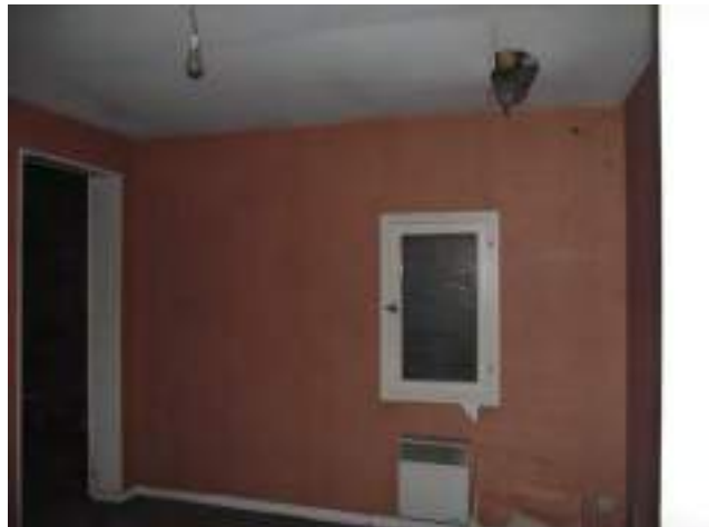
Chambre 2 s'éclairant sur le puits de jour (très insuffisant) Dégât des eaux
