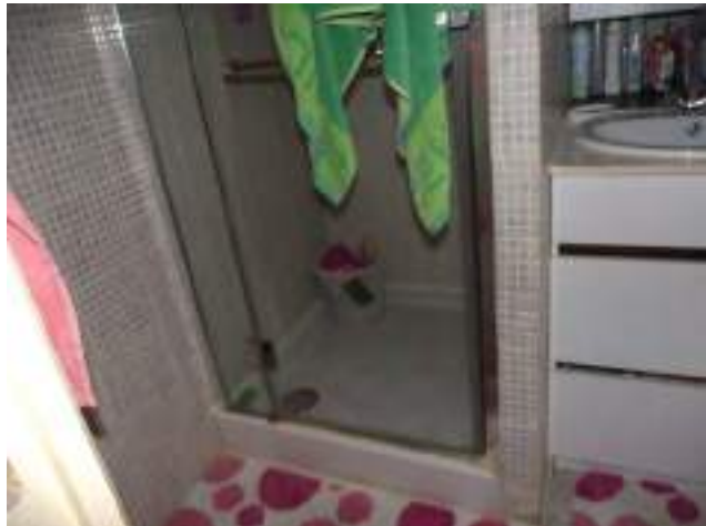
Salle d'eau nota : bouche d'extraction obturée
