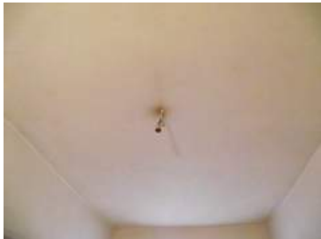
Détail : douille chantier avec fileries non protégées absence d'ampoule.
