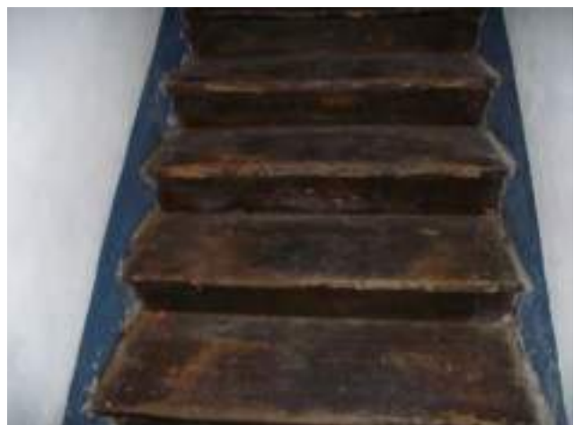
Escalier marches bois dégradées, couvrant les marches en pierre anciennes
